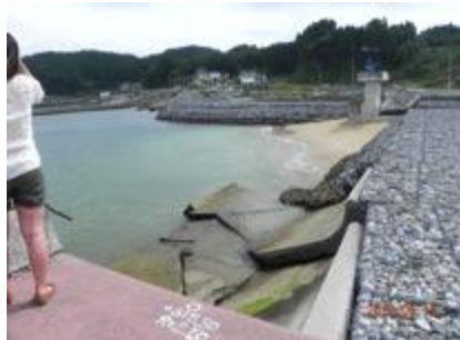
広田の海岸防潮堤も壊れたまま
